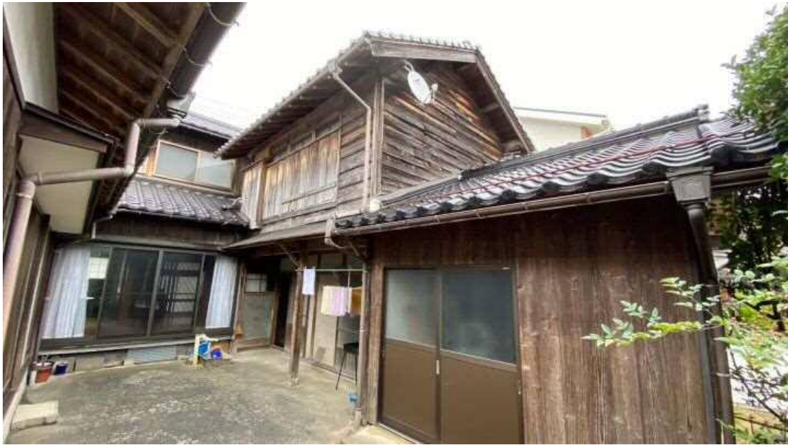
中庭の様子です。屋根が一部剥がれかかっています
